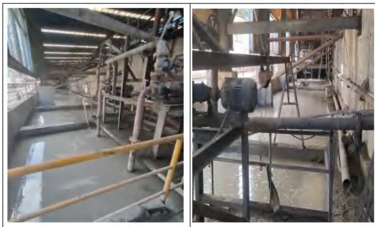
图 4.2-1 项目循环水池现场照片
